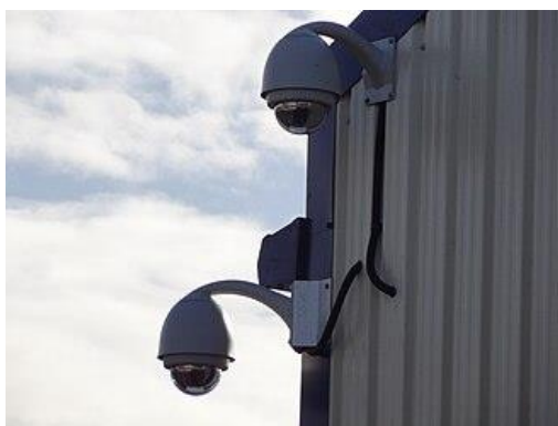
รูปที่ 6.2 กล้องวงจรปิดแบบโดม (Dome CCTV cameras)
