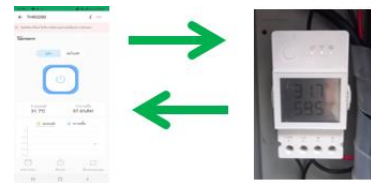
4. เชื่อมต่อโทรศัพท์มือถือเข้ากับ อุปกรณ์ควบคุมอุณหภูมิ และความชื้น
